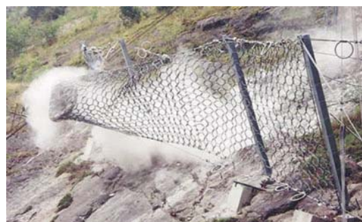
Fig. 9. Pantalla dinámica deteniendo un bloque desprendido (Geobrugg, 2009).
