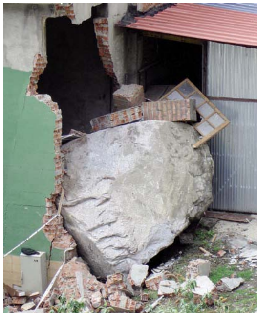
Fig. 2: Impacto de un desprendimiento en un edificio en Santa Coloma (Andorra) en abril del 2008. (Foto: Ramon Copons).
