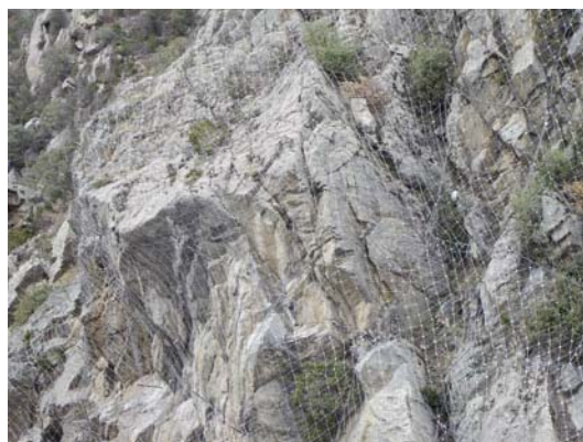
Fig. 21: Ejemplo de protección activa (malla pentifix) en Andorra la Vella en el año 2004. (Foto efectuada por R. Copons para Euroconsult S.A. en Andorra).
